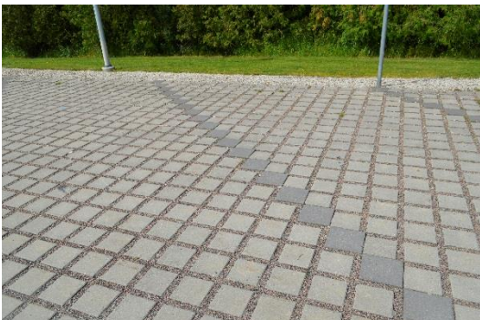
Figur 5. Genomsläpplig yta - användning av allmän platsmark för infiltration av dagvatten. Foto från Svedala.
